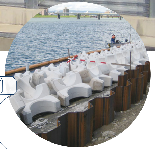
国土交通省 九州地方整備局 宮崎河川国道事務所(大淀川) ユークロス 2型
